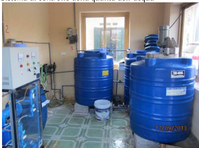
Sistema di controllo della qualità dell'acqua
